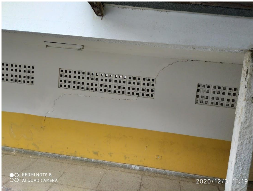
Foto 1 - Fissuras na alvenaria do corredor
