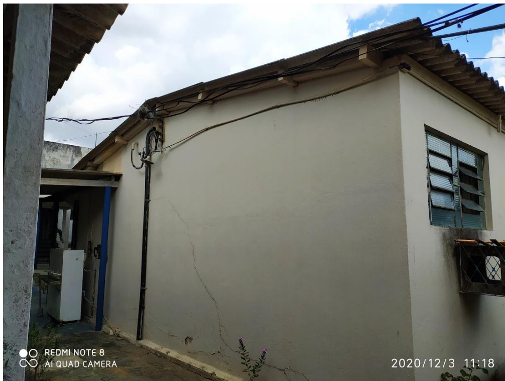
Foto 2 - Fissuras na alvenaria Lateral
